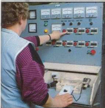
Banc d'essais de transformateurs.
